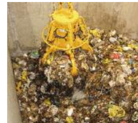
Avfallsbunkeren er utstyrt med robot-kran. Bilene kommer først inn i en "luktsluse" før en ny dør går inn til selve bunkeren.
