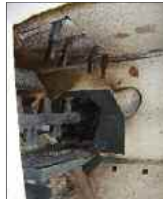
Inne i forbrenningskammeret. Mateskruen mater inn slammet og lager samtidig større overflate.
