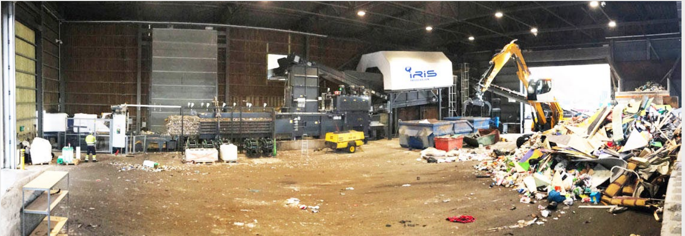
Produksjonslinja i den nye restavfalls-hallen på Vikan.
